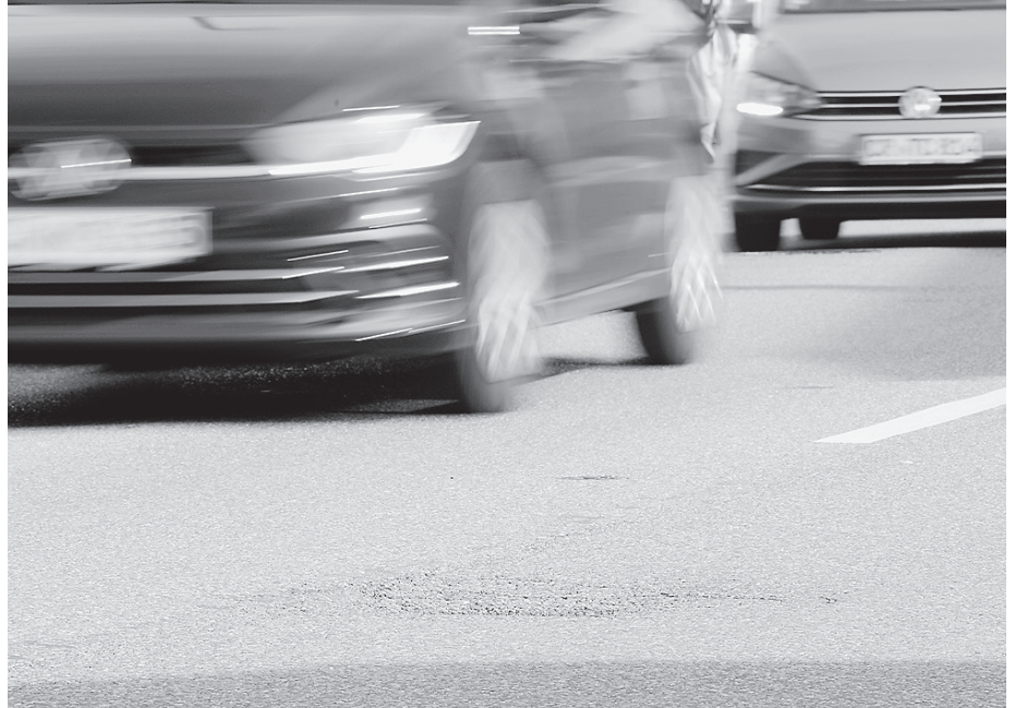
In der Gaildorfer Straße lässt die Stadt parallel zu den Arbeiten der Stadtwerke den Straßenbelag sanieren. Foto: Stadtverwaltung Crailsheim
