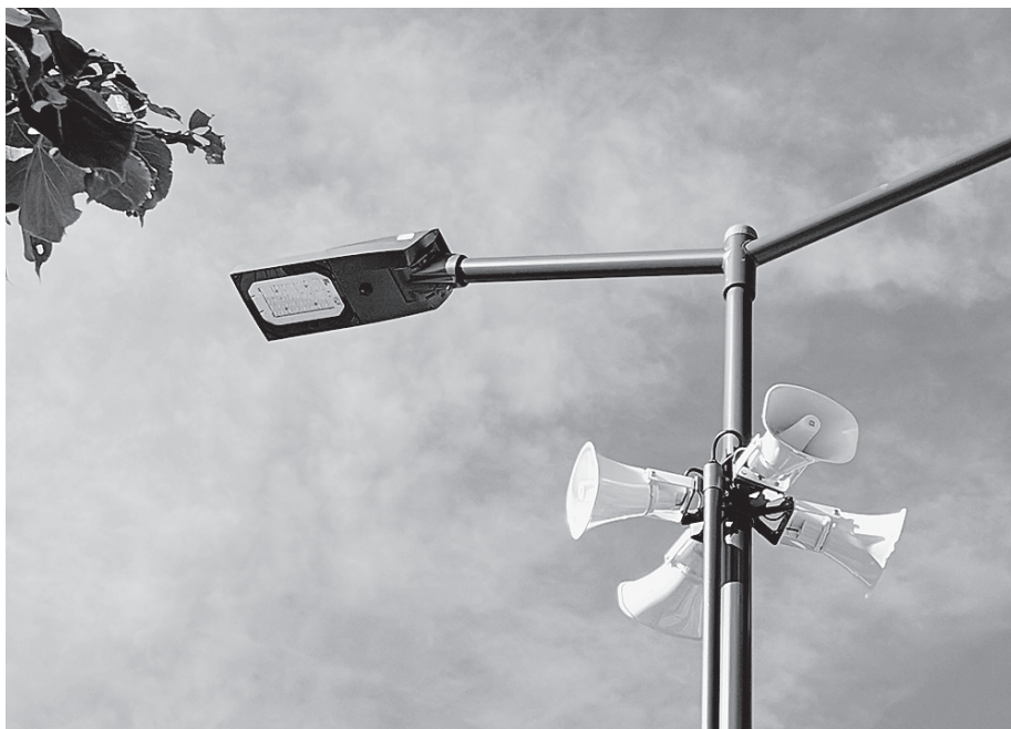
Die neue Lautsprecheranlage sorgt auf dem Volksfestplatz künftig für eine bessere Verständlichkeit wichtiger Durchsagen. Foto: Stadtverwaltung
