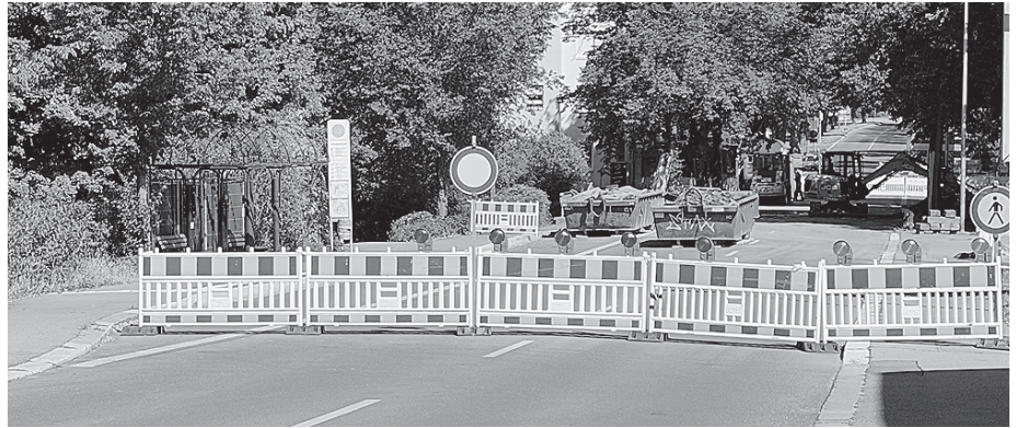
Die Blaufelder Straße im Bereich Schwanensee-Unterführung bleibt länger gesperrt als geplant. Foto: Stadtverwaltung
