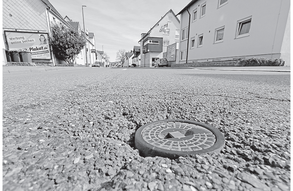
Schäden auf der Gaidorfer Straße werden ab dem 31. März beseitigt.
